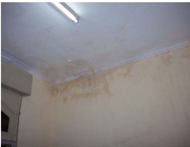
Muchos libros ubicados en los estantes superiores también se humedecieron por las filtraciones de agua provenientes de los techos.
